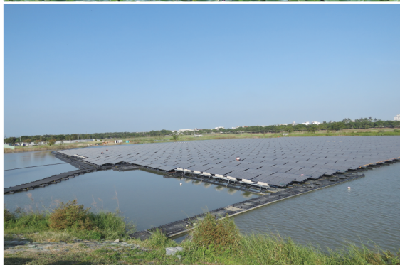
典寶溪B區滯洪池已完成光電板的設置
